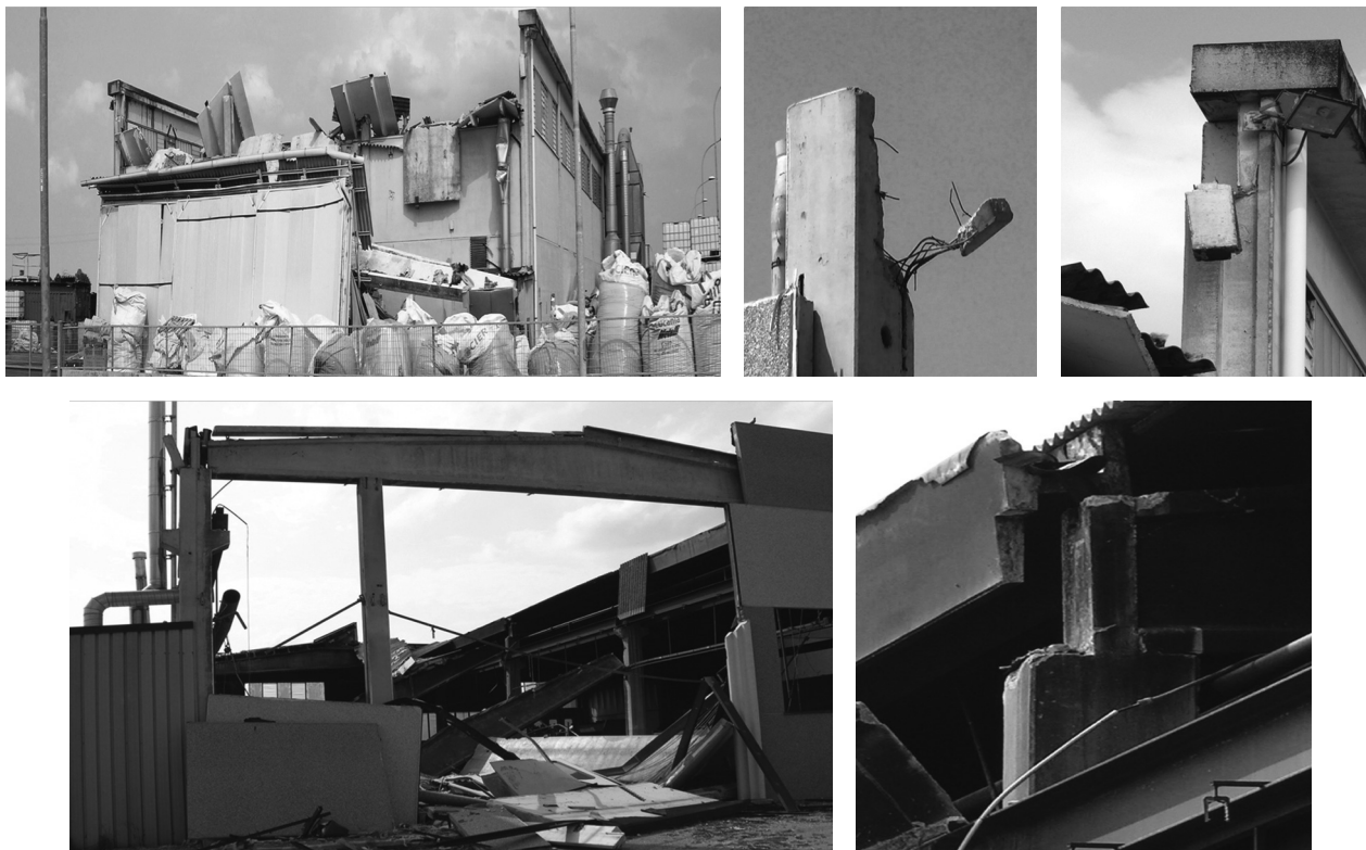
Fig. 8. Collapse due to the lack of supports: a) the breakdown of the upper fork; b) loss of support. Crolli per assenza di supporto: a) La rottura del collegamento superiore; b) perdita di sostegno.
