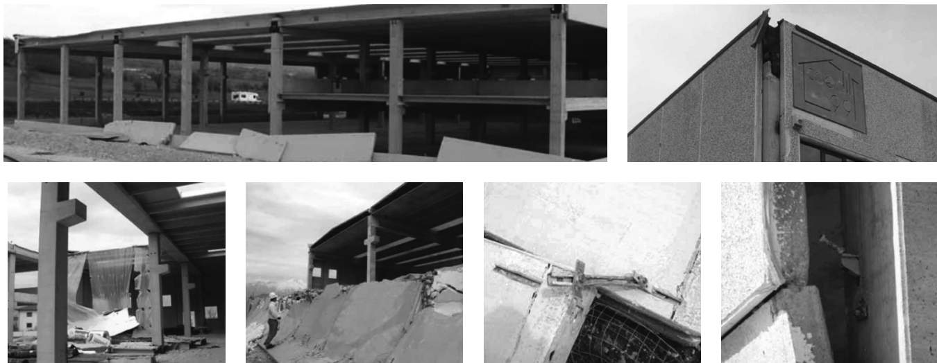
Fig. 5. P/p. r.c. structures in L'Aquila lack of adequate anchoring led to collapse L'Aquila (Myamoto 2009). Strutture prefabbricate a L'Aquila; mancanza di adeguate connessioni hanno comportato il crollo (Myamoto, 2009).
