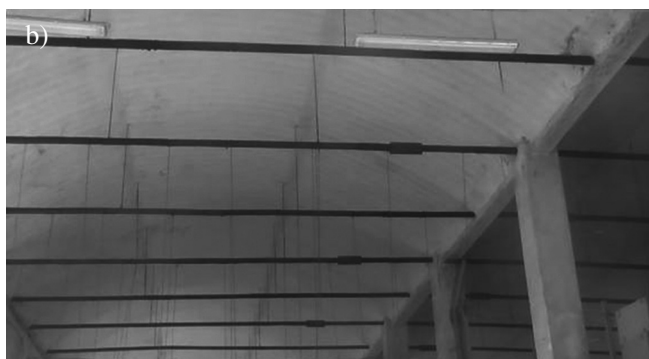
Fig. 12. Mixed masonry-prestressed structures: a) reduced resistance piers; b) presence of steel ties. Combinazione muratura-struttura prefabbricata: a) maschi di ridotta resistenza; b) presenza di catene.
