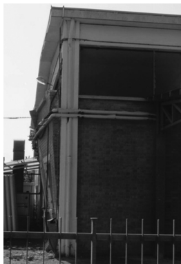
Fig. 11. Solid brick cladding damage. Danni a facciate in mattoni pieni.
